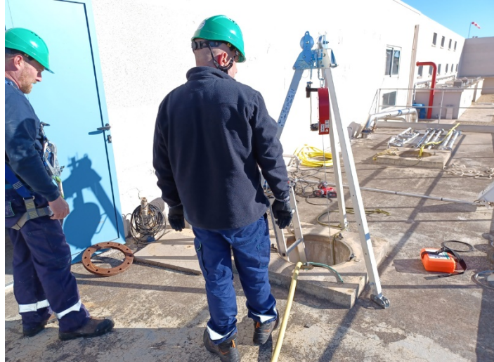
Intervention en sécurité dans une tour d'ozonation
