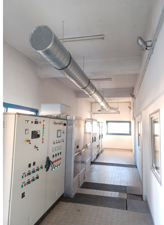
Climatisation gainable du local :
